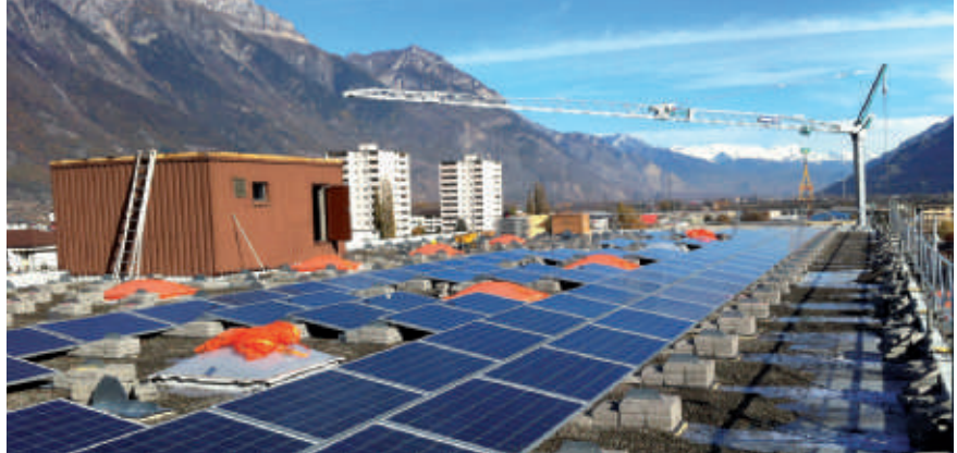
Solarpanels auf dem Dach der Caves Orsat, Martigny
